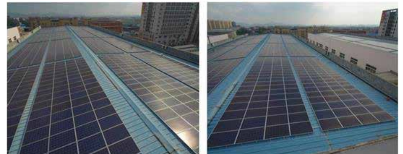
每栋楼的楼顶均有安装太阳能电池板
